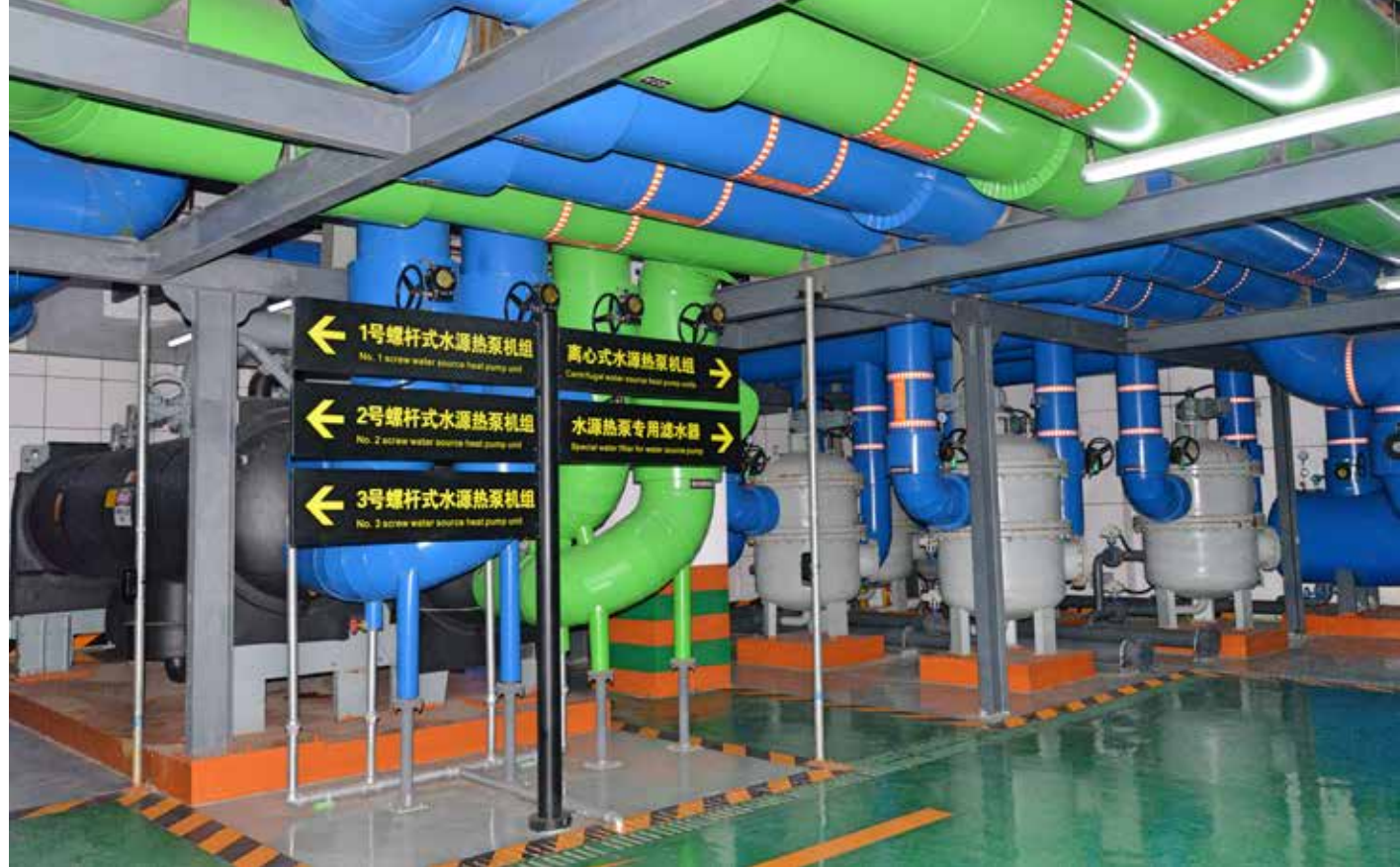
◎贵安云谷智慧能源站能源项目
