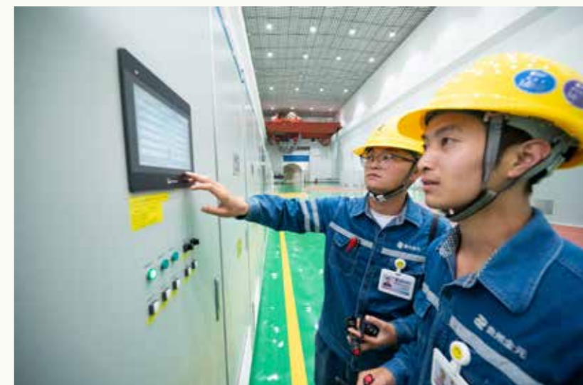
◎象鼻岭水电厂运行班巡视检查发电机层设备（杨平贵摄）
