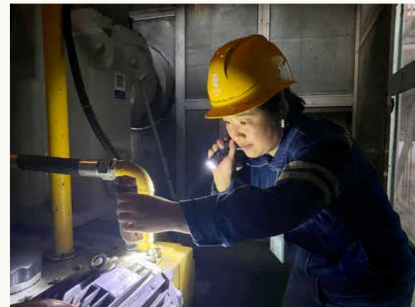
◎茶园电厂运行人员对所辖设备进行深度巡检（车瑛摄）
