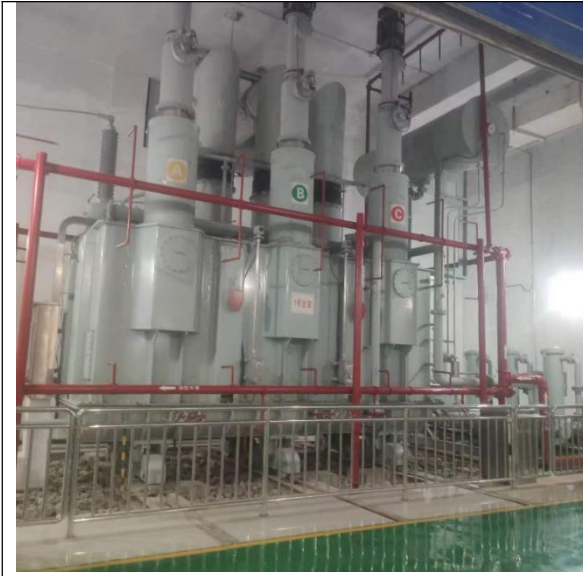
1#主变采取硬化措施的现状照片
