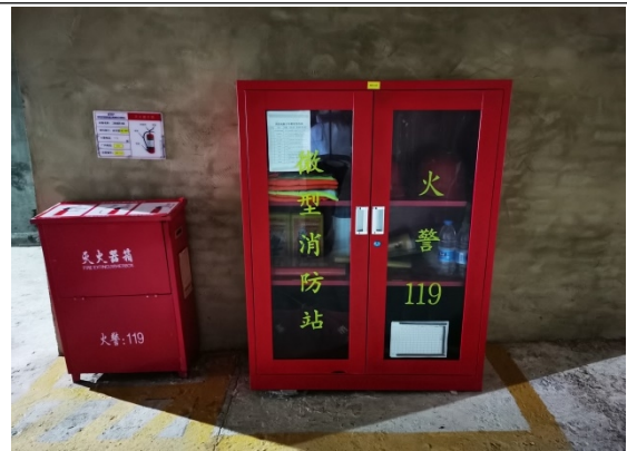
柴油储罐微型消防站
