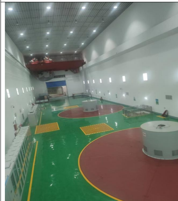
地下发电机房
