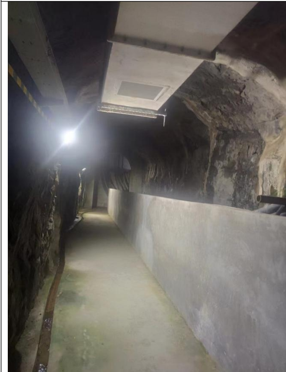
地下 220kV 高压电缆出线管廊采取硬化支护措施的现状照片
