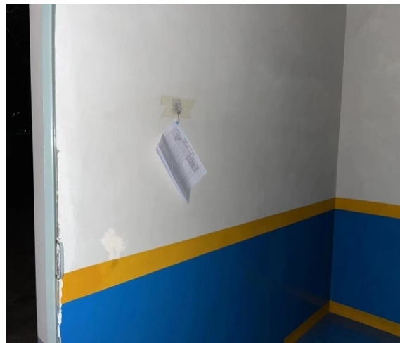
依托象鼻岭一期水光互补农业光伏电站危废暂存间内部的现状照片 2
