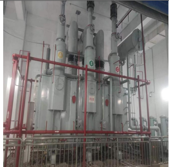
2#主变采取硬化措施的现状照片
