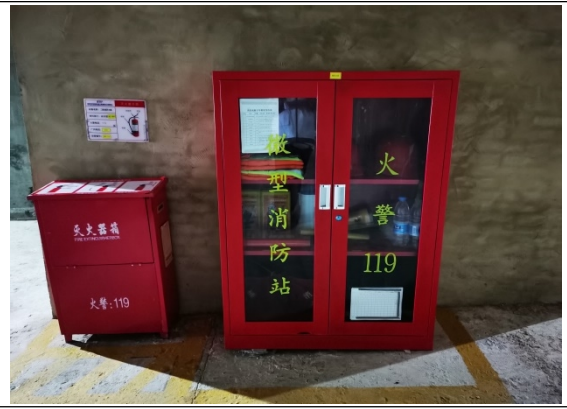
柴油储罐微型消防站
