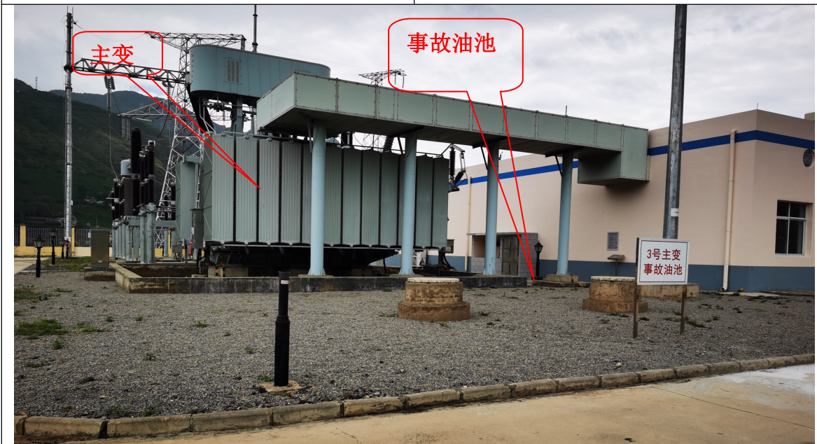
象鼻岭水光互补农业光伏电站主变和事故油池现状照片
